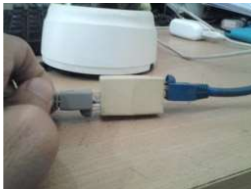
Gambar 5.2 Menghubungkan IP Camera dengan Kabel UTP
