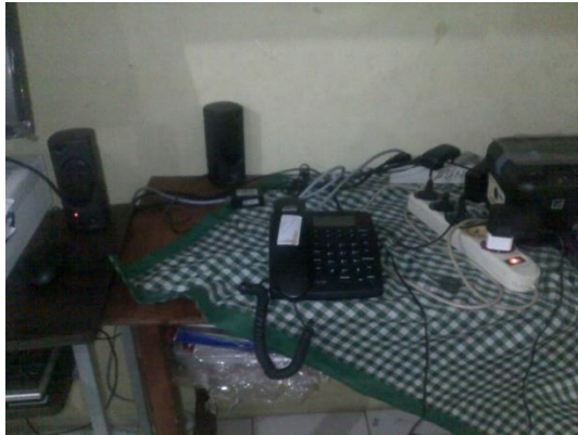
Gambar Pemasangan IP Phone di SD Negeri 12 Pangkalpinang
