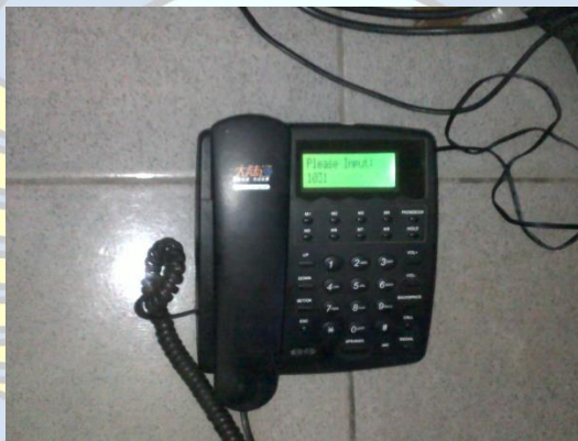
Gambar Pemasangan IP Phone di SD Negeri 6 Pangkalpinang
