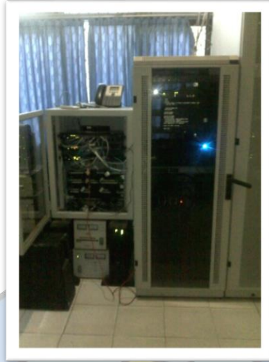
Gambar Pemasangan Server VoIP Briker di ruang ICT Dinas Pendidikan dan Kebudayaan Kota Pangkalpinang
