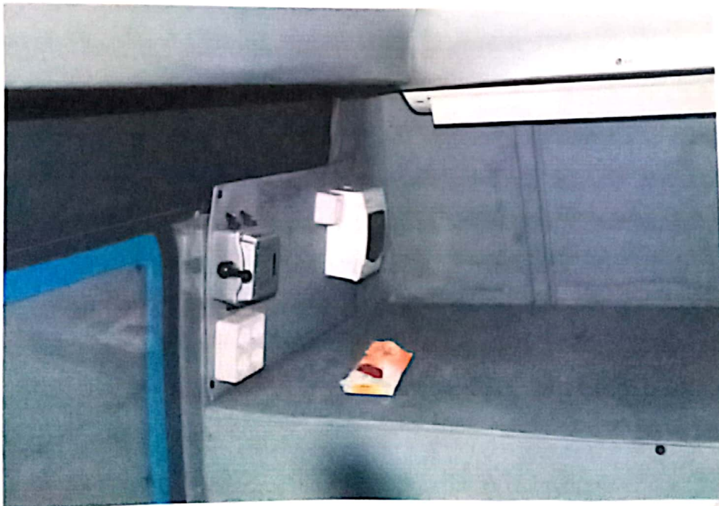
Poto Panel Listrik di Mobil Pelayanan Dokumen Kependudukan
